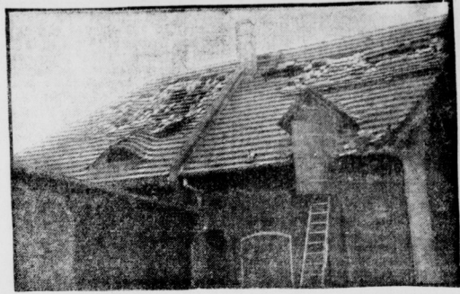
Ein durch den Luftdruck beschädigtes Dach, ungefähr 2 Kilometer entfernt, ebenfalls in entgegengesetzter Windrichtung.
