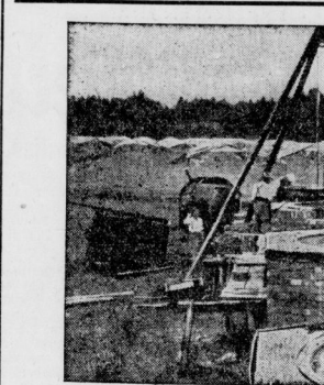
Vorbereitungen für Nordzug. Das riesige, gemauerte Kessel, in denen das Eisen für die Menschenmassen gefodert werden soll.
