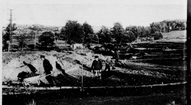
Der Bau des Rügendamms beginnt. Nachdem die äußerst schwierige Kostenfrage in langjährigen Verhandlungen geregelt ist, haben bei Stralsund die Anfangsarbeiten am Bau des Rügendamms begonnen. Dieser Damm soll die Insel Rügen mit Stralsund verbinden
