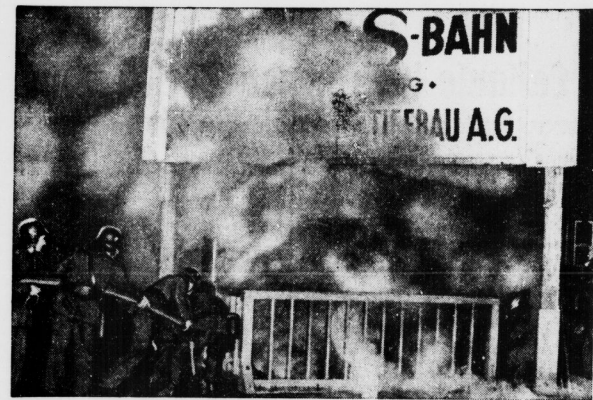
Das Großfeuer im Nord-Süd-S-Bahntunnel am Potsdamer Platz in Berlin. Am 3. Weihnachtstage war in den Abendstunden in der unterirdischen Baustelle des Tunnels der Nord-Süd-S-Bahn am Potsdamer Platz in Berlin ein Großfeuer ausgebrochen...
