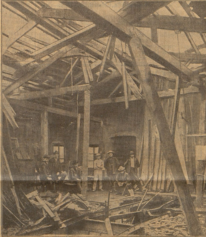
Ein zerstörtes Fabrikgebäude im Hafen von Genua.
