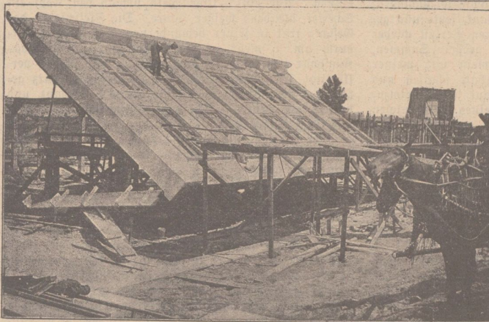
Häuserbau in 48 Stunden: Aufrichten der ersten Mauer. Phot. F. D. Koch, Berlin. (Text siehe Seite 320.)
