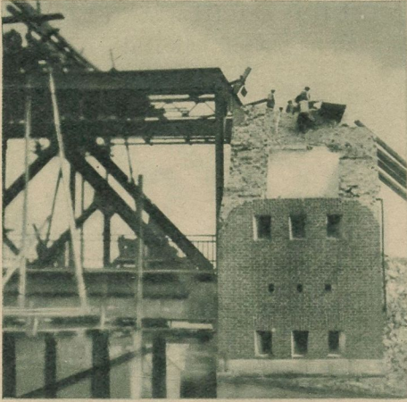
Die Weichselbrücke bei Münsterwalde in Strehren ist von Polen nunmehr für den Verkehr gesperrt. Die Zerführungsarbeiten an dieser mit einem Kostenaufwand von 9 Millionen von Deutschland im Jahre 1909 erbauten Verkehrsstraße sind offiziell von Polen angeordnet und haben begonnen. Lediglich eine kleine Fähre soll nunmehr den noch immer starken Verkehr vermitteln. (Vergl. unsere Veröffentlichung in Nr. 29 „L. S.“)
