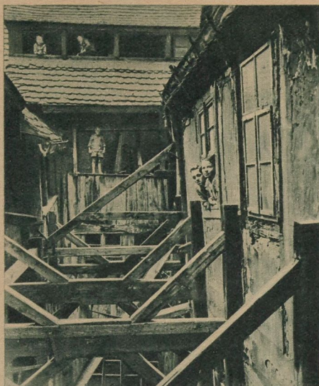
Die ältesten Häuser der Stadt Dresden in der über 400-jährigen Zwingerstraße drohen einzusinken. Die unmittelbare Gefahr ist vorläufig durch Abstützen mit Balken hinausgeschoben Grosf
