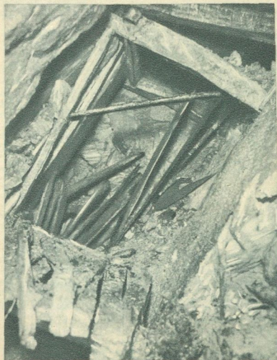
In einem alten Gang Rechts: Überall bringt Wasser ein
