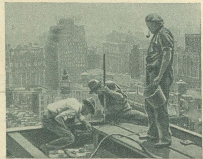
Bild rechts: Bei der Arbeit, trotz der Höhe ohne jede Sicherung
