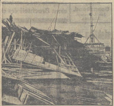
Der Stimmengausen des eingestürzten Kirchenneubaus.
