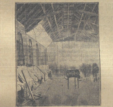
Der Telephonamt nach dem Einsturz. Eine 50 Meter lange Gipsdecke stürzte in den Saal des Weimarer Telephonamtes. Ein Getreter wurde getötet. Über die 25 anwesenden Telephonisten blieben wie durch ein Wunder unversehrt.
