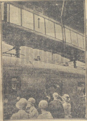
Die Lautsprecher-Anlage am Deckengewölbe des Berliner Bahnhofs Zoologischer Garten.
