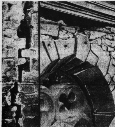
Links: Riß an der Westseite. — Rechts: Fensterbogen über der Uhr.
