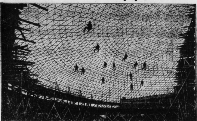
Die Dächerkoff & Widmann A.-G. hat ein System erfunden, das ermöglicht, Kuppeln nach dem sogenannten Strich-Verfahren zu betonen. Es wird zunächst das Gerippe der Kuppel aus Stahlscheiteln hergestellt und dann durch Anwendung von Druckluft allmählich das Holzgerippe einbetont.
