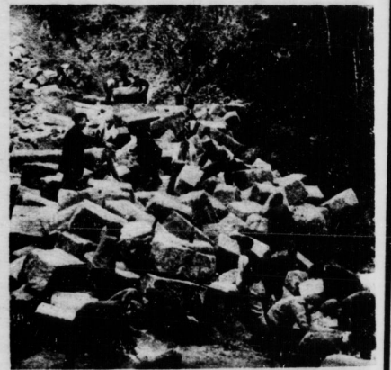
Ein Arbeiterturnballenbau durch Sportgenossen wird gegenwärtig in Vollzuge in der Gächfischen Schweiz ausgeführt. Unser Bild zeigt den Transport der selbstgebrochenen Steine zur Baustelle
