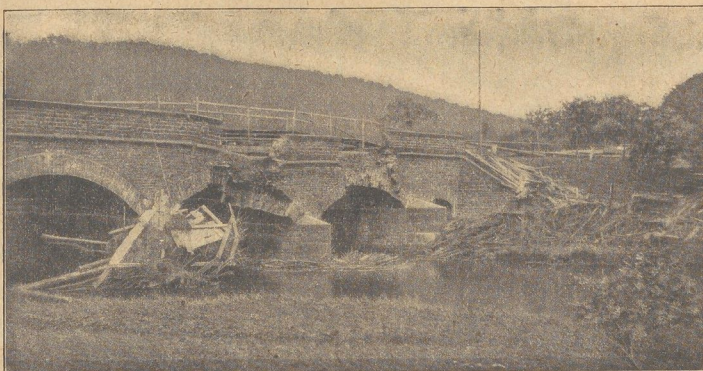
Zur Hochwasserkatastrophe im Ahrthal: Die zerstörte Brücke bei der Ortschaft Schuld.
