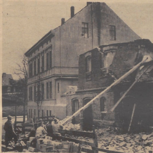
Ein Verkehrshindernis fällt: Abbruch des Lüdeshen Speichers an der Ecke Weißenfeller Straße - Sand. Das Material des massiven Baues wurde den Stadtrandfriedern überlassen.
