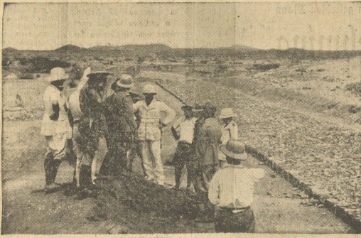
Fieberhaft wird in Eritrea an der Ausgestaltung der Straßen gebaut, um für die motorisierten Truppen und den Nachschub brauchbare Verbindungen mit der kämpfenden Truppe herzustellen. Unser Bild zeigt den Bau einer Straße in Eritrea während einer Besichtigung durch den Oberkommandierenden, General del Bono und General Lessona
