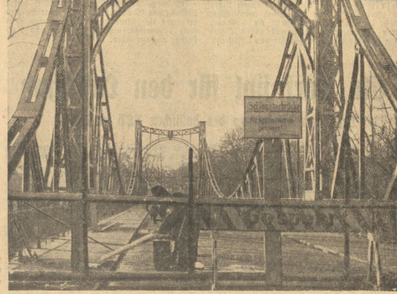
Die Schlagwerkbrücke ist zur Zeit gesperrt. Die Eisenverbindungsstege in der Mitte der Brücke müssen erneuert werden, hierdurch wird die Brücke in der Mitte gleichzeitig um 4 cm gehoben.
