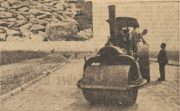
Die gesamte Breite der Straße beträgt 21 Meter, davon entfallen neun Meter auf die eigentliche Fahrbahn, die eine Decke aus Kleinsteinplaster tragen wird. Die Gestaltung, als Unterbau der Kleinsteindecke, besteht aus Packlage und Steinbelag. Auf die beiden Handstreifen zu beiden Seiten der
