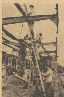
Männer der Technischen Nothilfe bei Instandsetzungsarbeiten auf dem Bahnhof Wreschca im befreiten Warthegau
