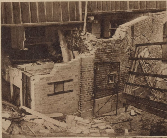
↑ Wie sich die Folgen des unterirdischen Wassereintruchs in das Kaliberbergwerk an der Oberfläche auswirkten: Die Grundmauern der dem Bergwerk benachbarten Zuderfabrik verankerten im Grund, so daß die Wände nachrutschten und der obere Gebäudeteil in der Luft hängt. S. B. B. 3.
