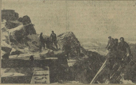
Die Gipfelstation der Bayerischen Zugspitzbahn wird ausgebaut und ein Pfeiler der Materiacbahn aufgestellt. 2964 Meter hoch.
