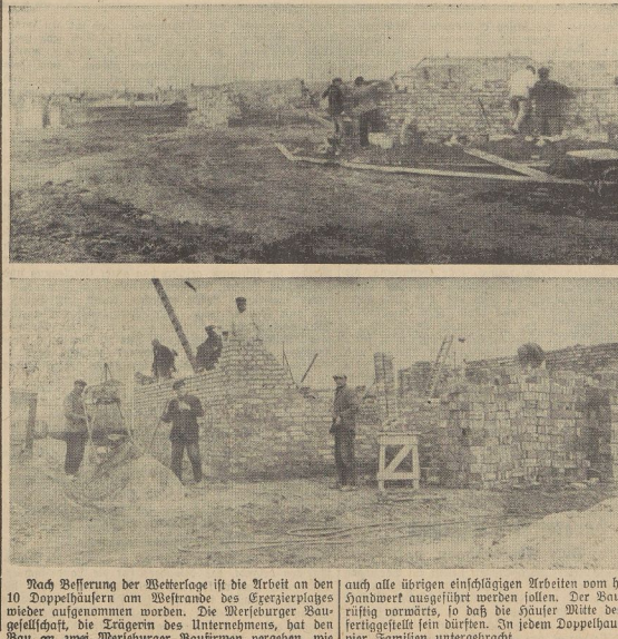
Nach Befreiung der Wetterlage ist die Arbeit an den 10 Doppelhäusern am Westrande des Exerzierplatzes wieder aufgenommen worden. Die Merseburger Bauhilfschaft, die Trägern des Unternehmens, hat den Bau an zwei Merseburger Baustraßen begonnen, wie auch alle übrigen einschlägigen Arbeiten vom heimischen Handwerk ausgeführt werden sollen. Der Bau schreitet fortgemäht, so daß die Häuser Mitte des Jahres fertiggestellt sein werden. In jedem Doppelhaus werden vier Familien untergebracht.
