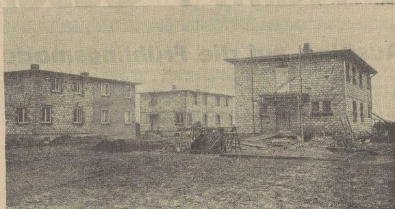
Unsere Bilder zeigen einen Ausschnitt aus der östlichen Straße auf dem Siedlungsgelände, dem Ammelweg, und eine Baugruppe. Bemerkenswert ist dabei, daß der Einheitsstil bei den weiteren Bauten durchgehalten werden wird, da es jedem Bauwilligen freigestellt ist, wie er sein Haus architektonisch gestalten will.
