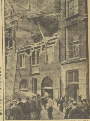
In Rotterdam führte ein Speicher, der mit 1 Million Kilogramm Erbsen überlastet war, zum Zusammenbruch. Die ganze Erbsenmenge ist auf der Straße verstreut.
