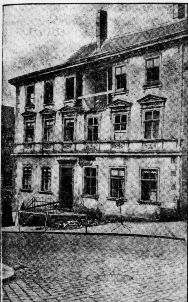
Das Bild zeigt den Zustand des Hauses Soloberg 1 nach dem Einsturz der Außenmauer. Die obere Stockwerke sind zerstört, und die innere Struktur ist freigelegt.
