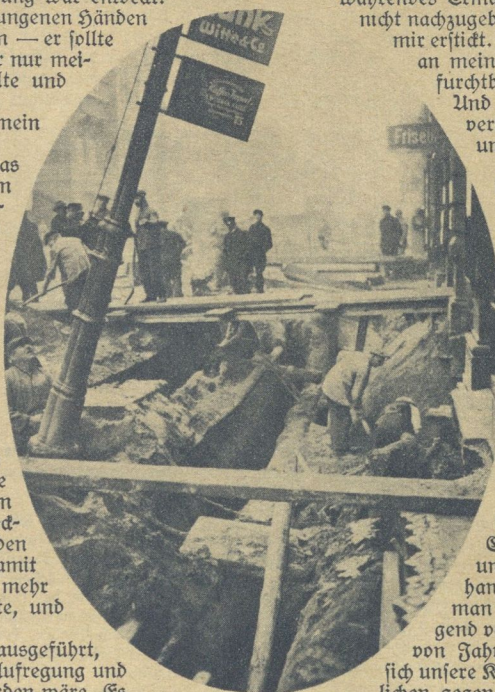
Ein folgenschwerer Wasserrohrbruch vor einem Berliner Hause
