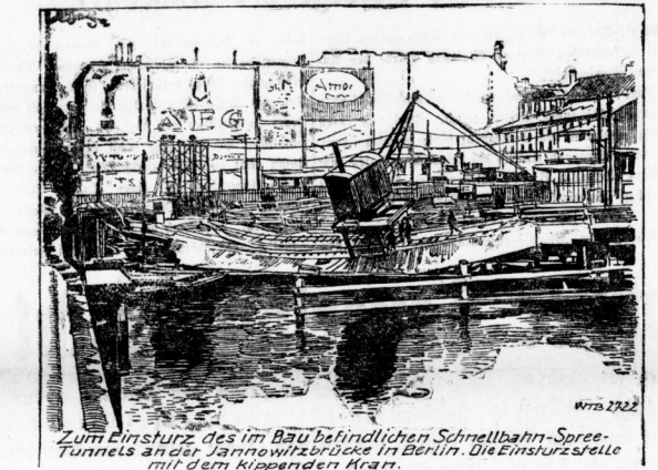
Zum Einsturz des im Bau befindlichen Schnellbahn-Spreetunnels im Bahnhofsgebiet Berlin. Die Einsturzsprelle mit dem Kippenden Kran.
