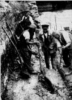
Die vom Hochwasser beschädigte Stützmauer an der Schwarzen Brücke wird, soweit erforderlich, weggebrochen. (Aufnahmen: Giögelschilling)
