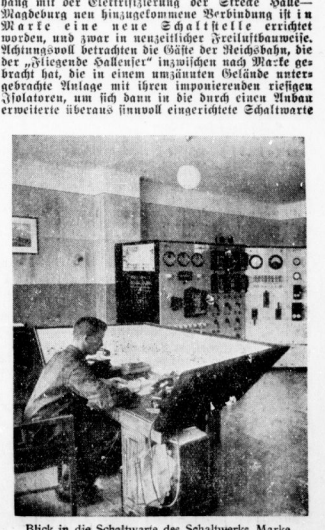
Blick in die Schaltwarte des Schaltwerks Marke
