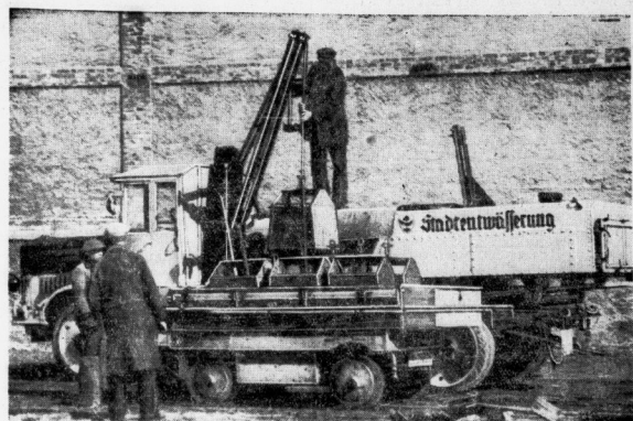
Säuberung von Sinkkästen, die in die Straßenabläufe eingebaut sind, um den vom Regenwasser mit eingespülten Straßenschmutz aufzufangen
