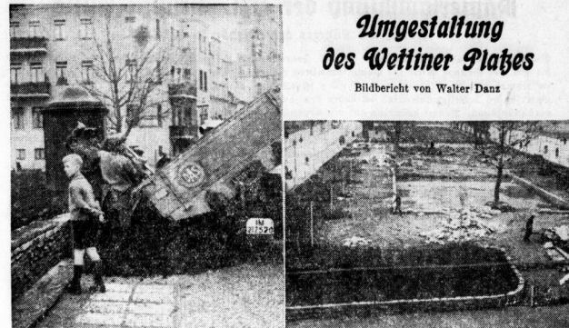
Der Mutterboden für die gärtnerischen Neuanlagen wird angefahren. In den ersten Umrissen zeichnet sich die neue Form des Wetziner Platzes ab. Die herausgenommenen Platanen werden durch Neuanpflanzungen ersetzt.
