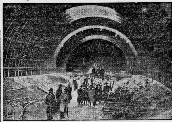
Die Bauplätze von Liverpool und Birkenhead beschäftigt den Meeresunter, der unter dem Merseyfließ amfischen den beiden englischen Seehäfen gebaut wird. Durch den 3 1/2 Kilometer langen Tunnel soll eine Bahn
